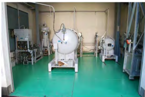
5. 防爆試験装置 (防爆試験槽)
