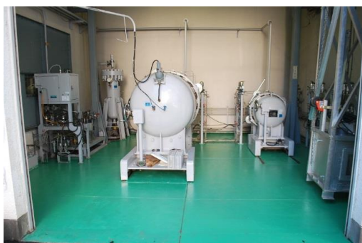
5. 防爆試験装置 (防爆試験槽)
